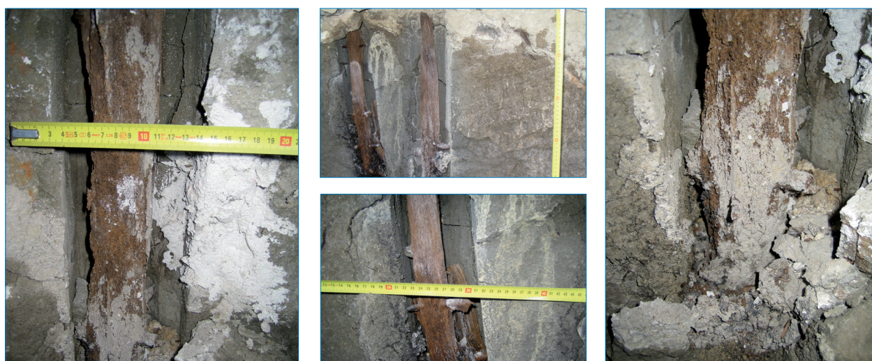
Los pilotes de sustentación del puente estaban totalmente descompuestos, habiéndose reducido su tamaño original de 12-14 cm de ancho a un máximo de 5-6 cm.
