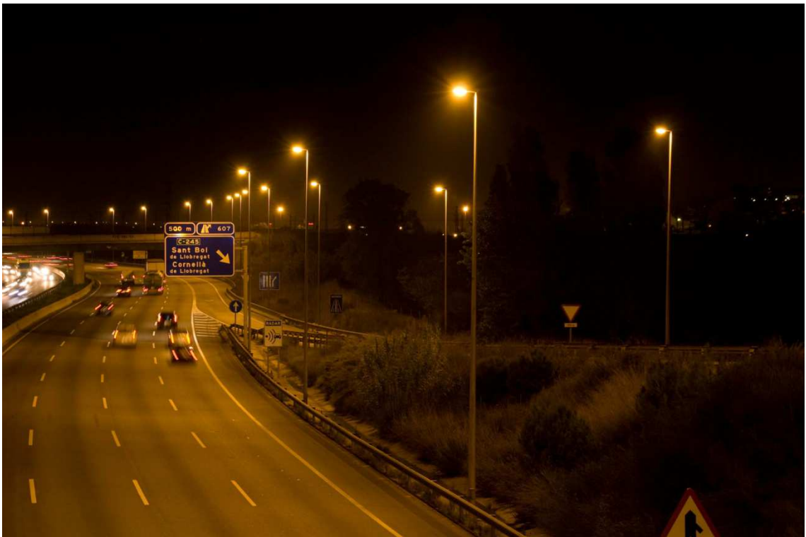
Fotografía 4. Autovía A-2. Sección tipo con dos calzadas y cuatro carriles cada una. Iluminación con tecnología VSAP. Interdistancia 40 m. Tipo de implantación: axial.
