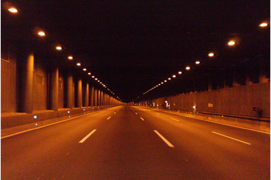
Fotografía 5. Túnel de las calzadas superpuestas M-40. Iluminación con VSAP. Zona interior (sentido de la marcha).
