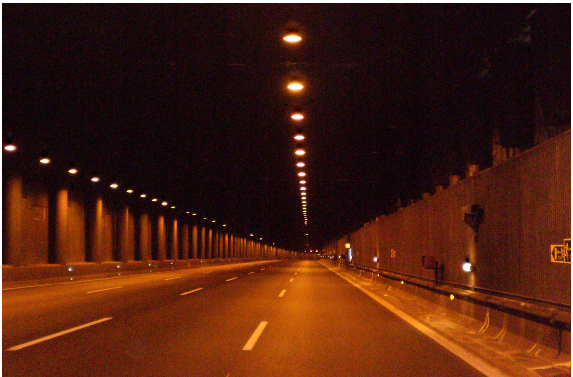
Fotografía 6. Túnel de las calzadas superpuestas M-40. Iluminación con VSAP. Zona interior (sentido de la marcha).
