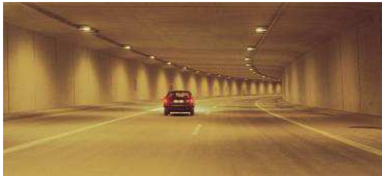
Figura 3.2. Túnel iluminado con lámparas de vapor de sodio alta presión.
