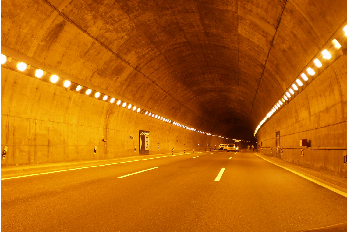
Fotografía 2. Túnel de Somosierra. Iluminación con VSAP. Umbral boca norte (sentido de la marcha) con todo el alumbrado encendido.
