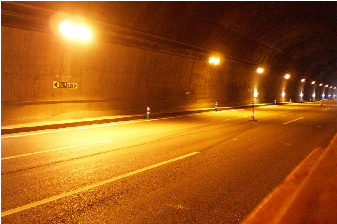
Fotografía 4. Túnel de Somosierra. Iluminación con VSAP. Transición 3 de boca sur (sentido contrario al de la marcha) con todo el alumbrado encendido. Luminancia media 18 cd/m 2 .
