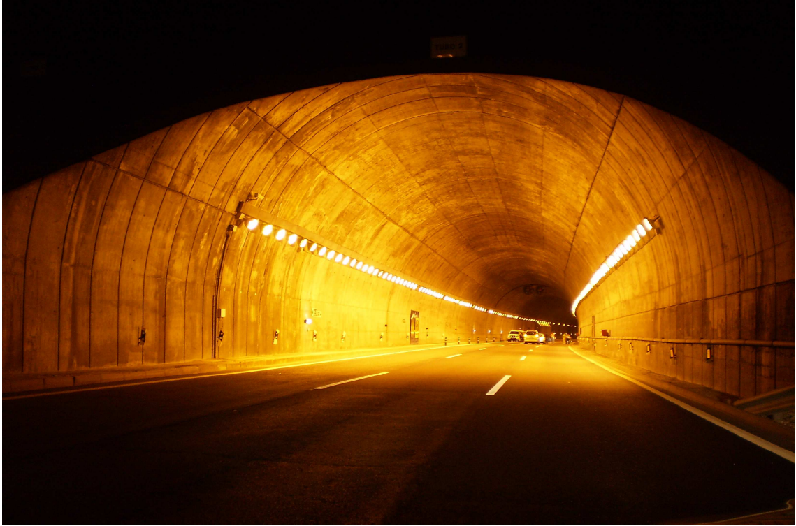
Fotografía 1. Túnel de Somosierra. Iluminación con VSAP. Boca norte (sentido de la marcha) con todo el alumbrado encendido.
