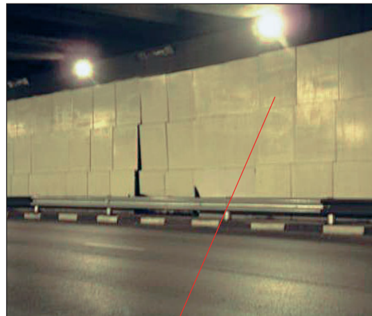
Revestimiento (GRC, homigón reforzado con fibra de vidrio)
