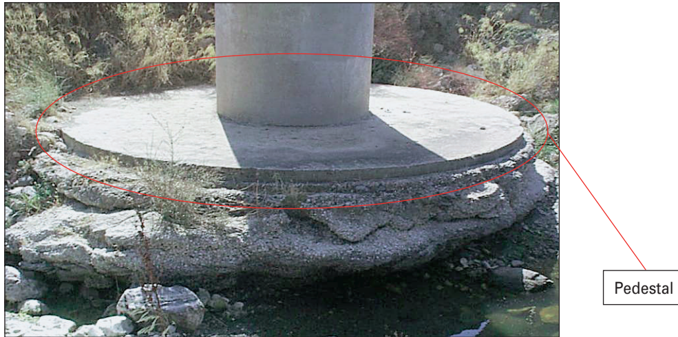
FIGURA 97. PEDESTAL EN PILAS.
