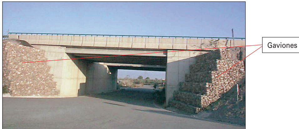
FIGURA 151. PROTECCIÓN DEL TERRAPLÉN MEDIANTE GAVIONES.
