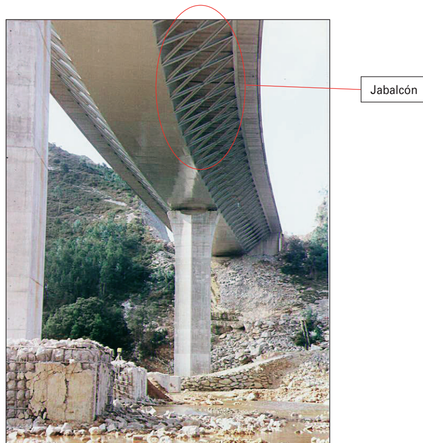
FIGURA 47. JABALCONES EN TABLERO.
