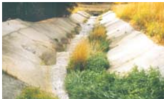
Figura 9.8 – Bajante de protección del terraplén con las paredes laterales en pendiente, adaptadas para facilitar los movimientos de fauna. Foto: C. Rosell.
