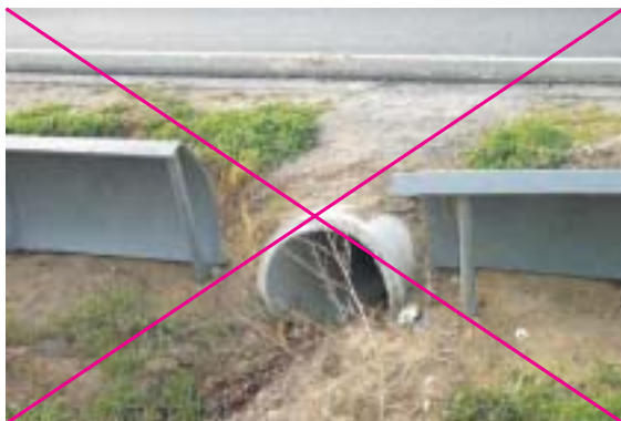
Figura 11.8 – Desajuste entre la estructura de guía y el acceso al paso para anfibios. Foto: C. Rosell.
