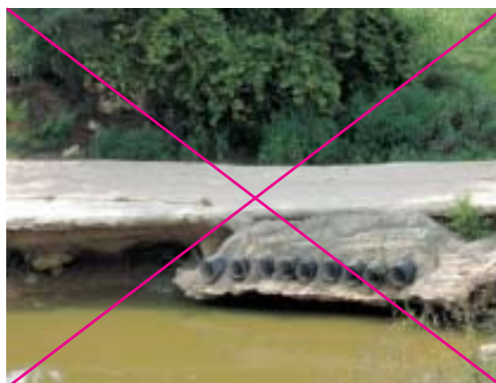
Figura 5.8 – Camino de obra que ha interrumpido la continuidad del curso fluvial. Foto: R. Campeny.
