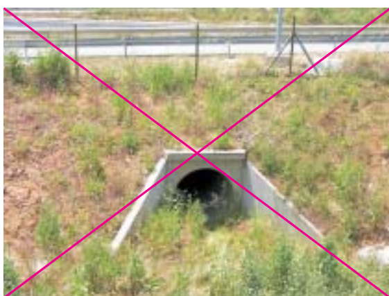
Figura 12.6 – Instalación incorrecta del cerramiento perimetral. Foto: M. Fernández Bou.
