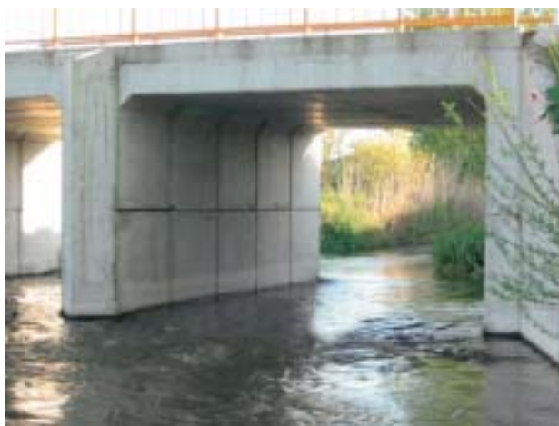
Figura 10.2 – Drenaje por el que discurre una lámina de agua permanentemente. Foto: J. García Molinos.
