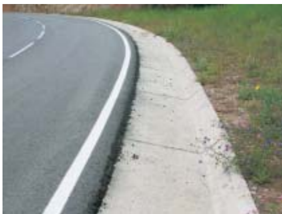
Figura 20.2 – Cuneta que permite un fácil acceso a los márgenes de la vía de los animales que hayan cruzado la calzada. Foto: F. Navàs.
