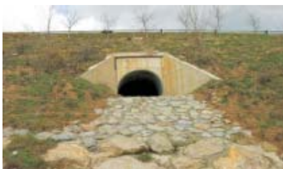
Figura 9.7 – Encachado que sustituye un bajante escalonado en la salida de un drenaje. Foto: C. Rosell.
