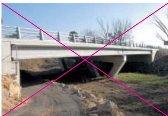
Figura 5.9 – Mala disposición de las pilas dentro del cauce. Foto: F. Navàs.
