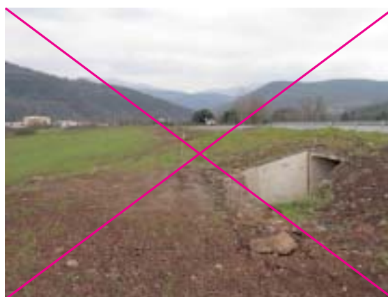
Figura 12.7 – Accesos obstruidos por movimientos de tierras destinados al paso de un gasoducto. Foto: F. Navàs.
