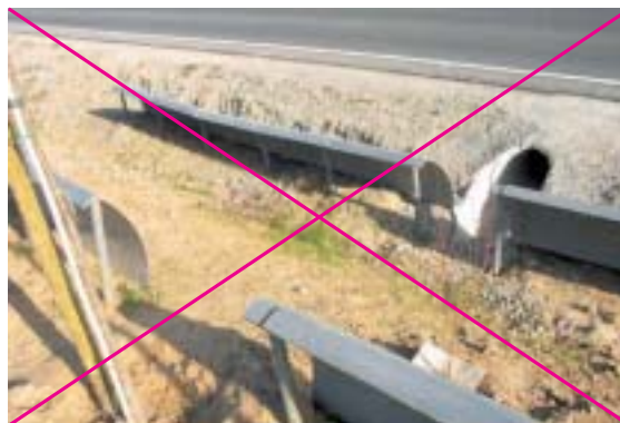
Figura 11.9 – Discontinuidad entre distintos tramos de las vallas de guía. Foto: F. Navàs.
