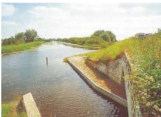
Figura 9.3 – Rampa que facilita una óptima conexión de los taludes con las plataformas secas del drenaje. Foto: H. Bekker.
