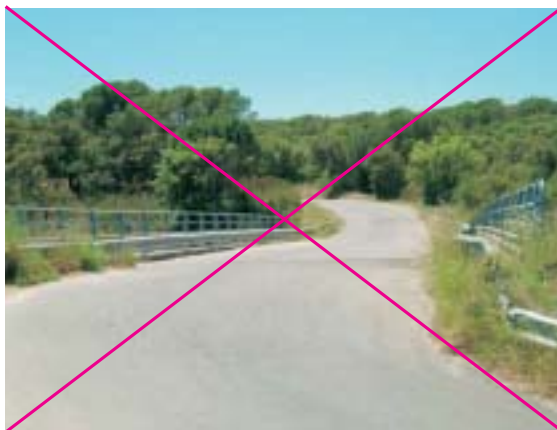
Figura 3.5 – Paso que podría haber sido acondicionado para la fauna colocando pantallas de madera y revegetando las franjas laterales. Foto: F. Navàs.
