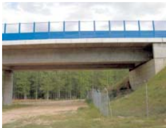
Figura 5.6 – Cerramiento continuo entre ambos lados del viaducto. Puede mejorarse adosando la malla al estribo del viaducto. Foto: R. Campeny.
