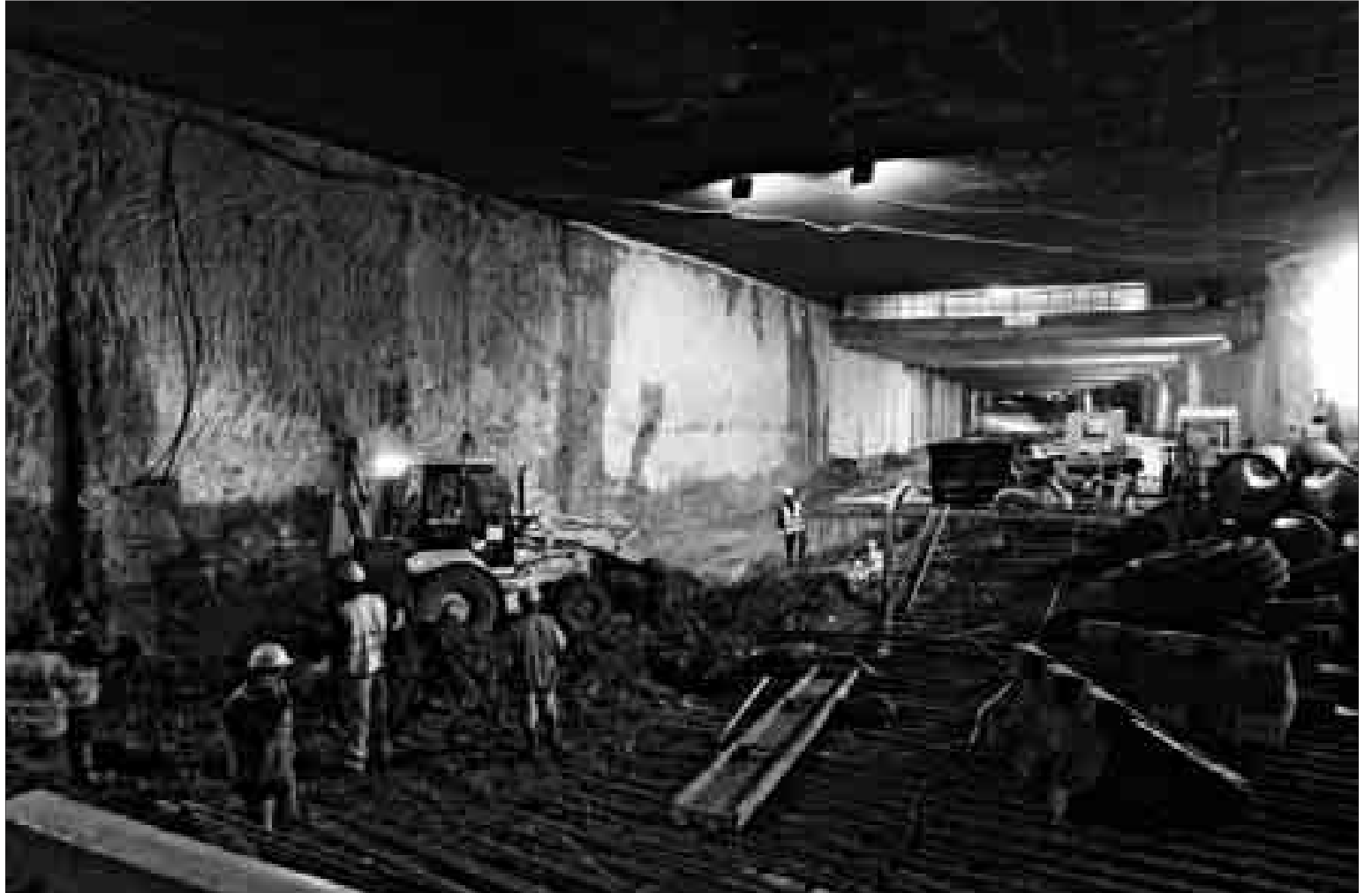
Los trabajadores de la M-30, ayer, durante la visita de Alberto Ruiz-Gallardón a los túneles de la Avenida de Portugal. / JOSÉ AYMÁ
