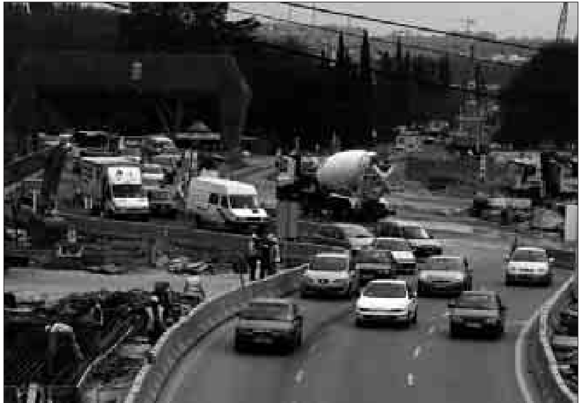
Una de las curvas peligrosas del sur de la M-30, junto al puente de Toledo. / JAIME VILLANUEVA
