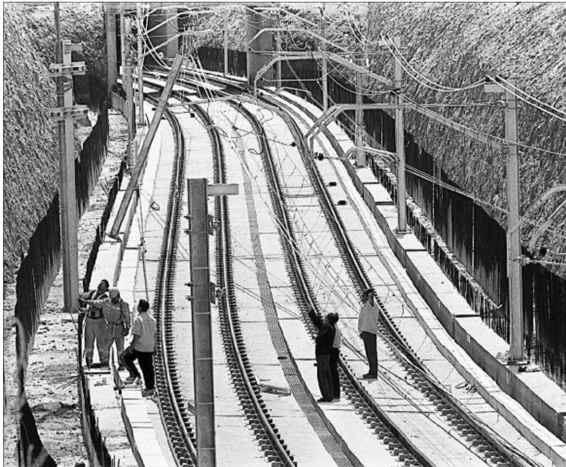
Unos operarios reparan en mayo de 1999 la caída de la catenaria sobre la vía en un tramo del metro a Arganda. / U. MARTÍN
