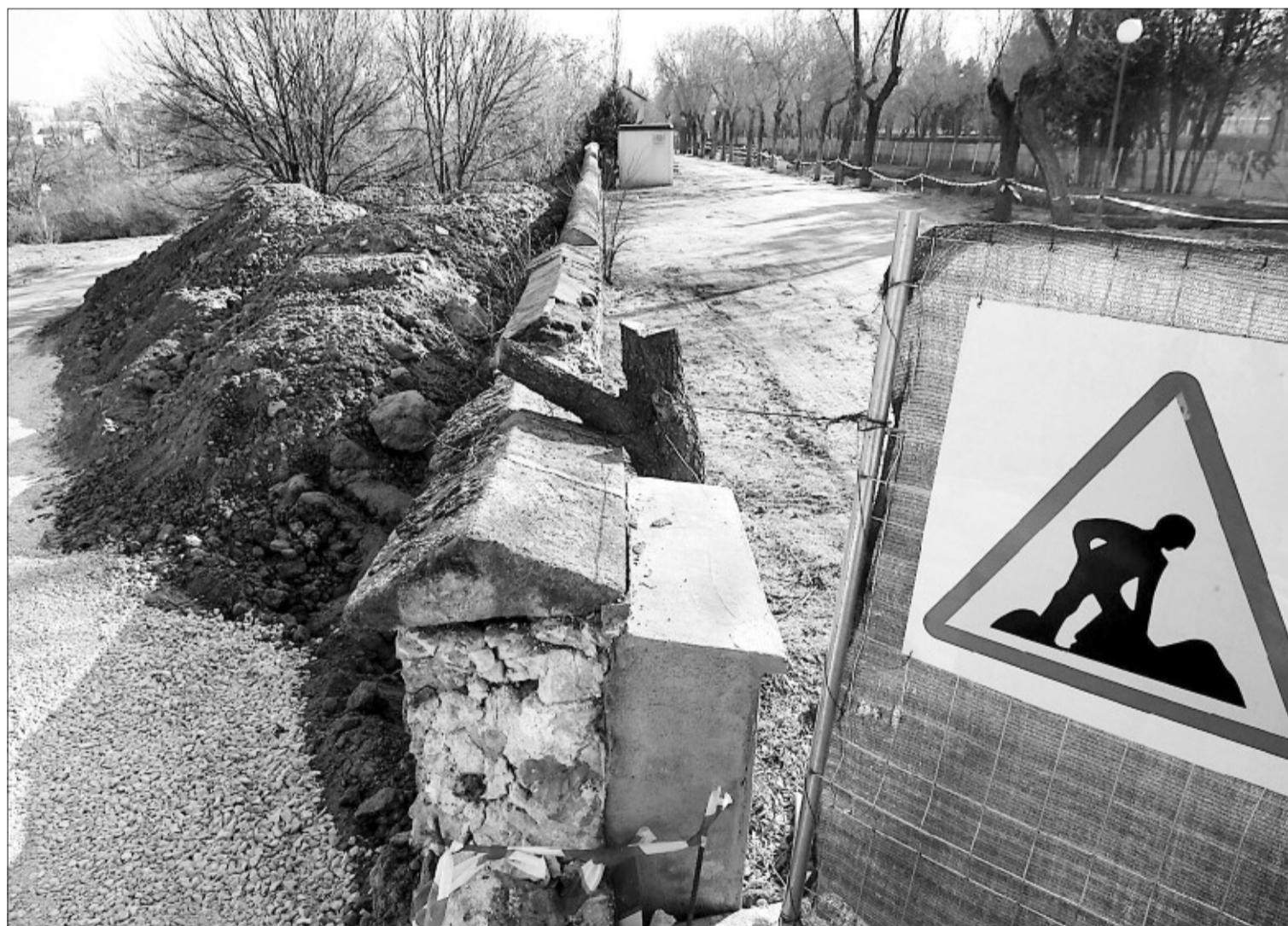
Tapia de la Casa de Campo demolida parcialmente por las obras de la M-30. / GORKA LEJARCEGI
