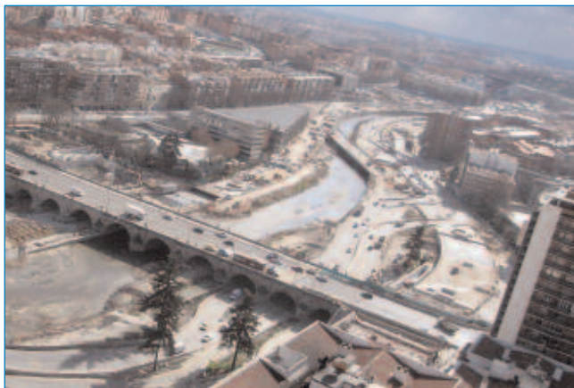
Situación actual de las obras de la M-30 en el entorno del Puente de Segovia.
